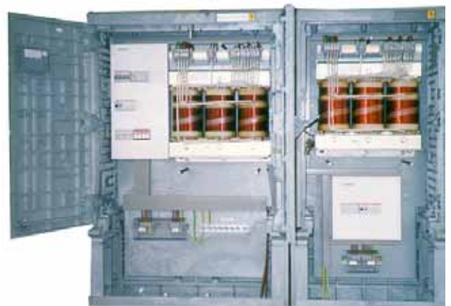
Referenzobjekt Postenschrank im Bereich Halle (Saale) Variante mit 10 kVA-Trenntrafo
